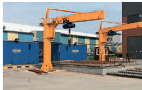
Снегоплавильный пункт, оборудованный консольными кранами.
